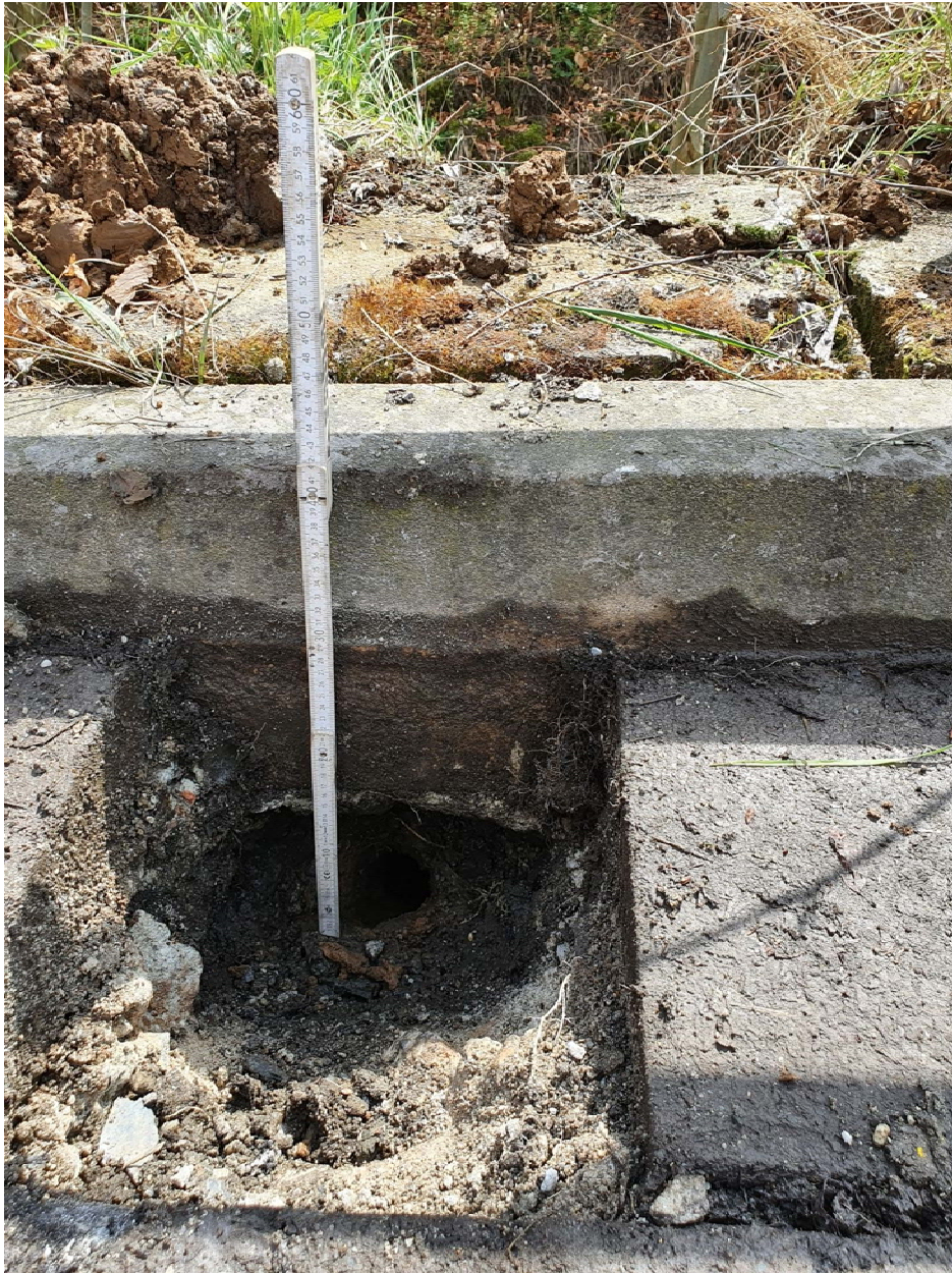
Bild 5: K 8768 Sürßen, Bachgeländer, Schurf S 13a fahrbahnseitig
