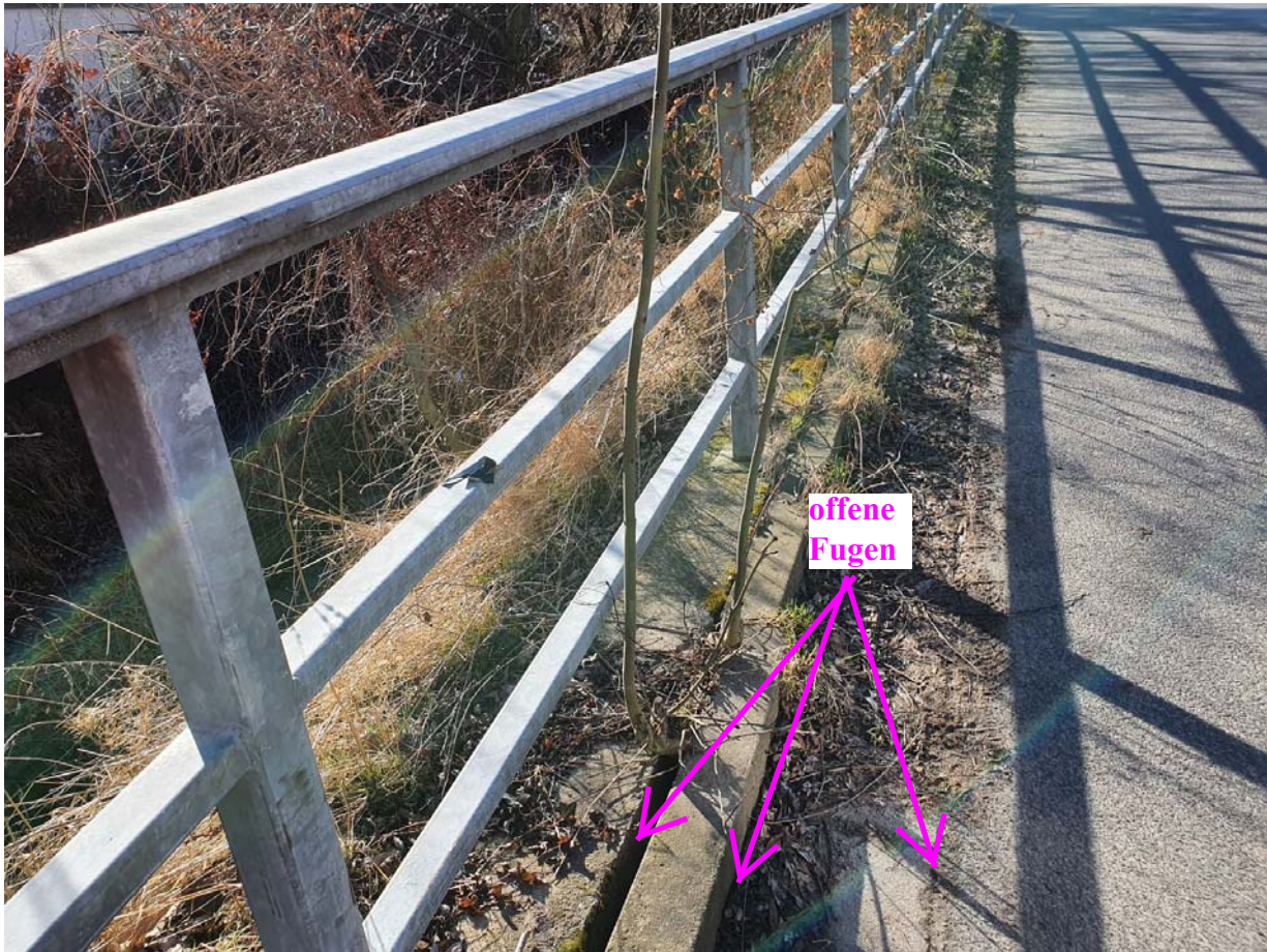
Bild 3: K 8768 Sürßen, Schadensbild Bachgeländer
